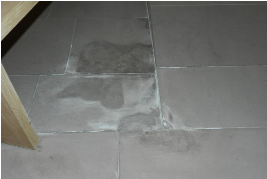
Fußboden mit Ausblühungen unter einer Sitzbank, Foto: AN
